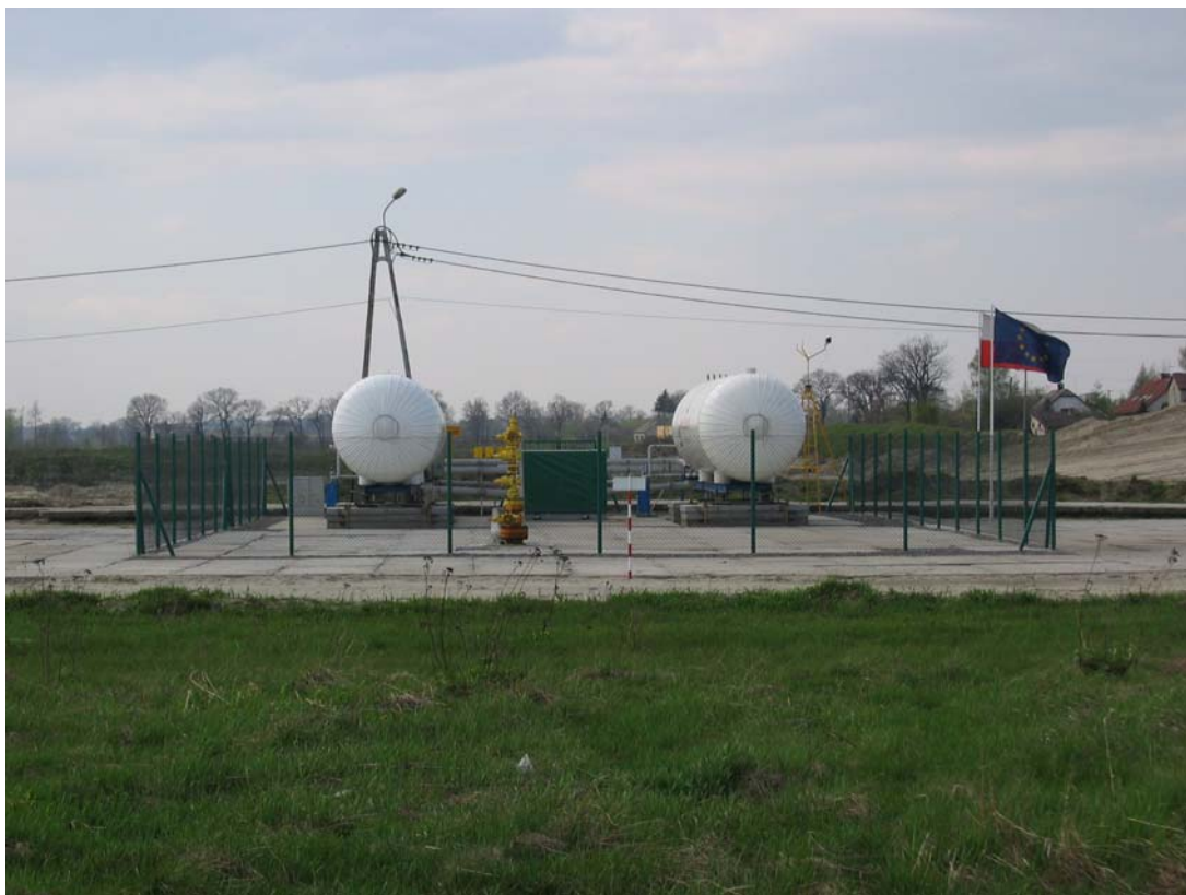
Figura 4.7. Tanques de compresión y pozo de inyección en el emplazamiento de RECOPOL
