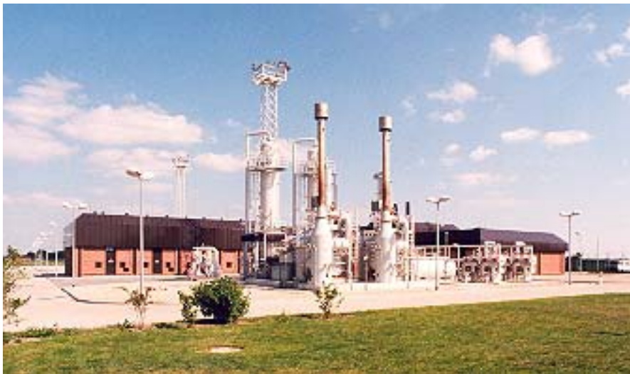
Figura 2.2. Instalación de almacenamiento de gas natural en Nuettermoor, Alemania.
